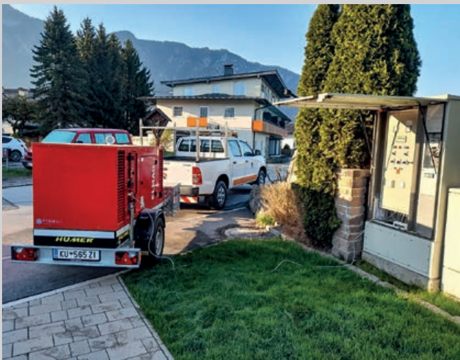
Eines der neuen Notstromaggregate im Einsatz bei der Pumpstation Postwirt.
