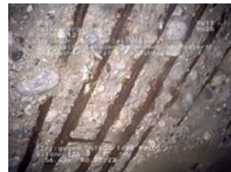
Unterhalb des abgesperrten Bereiches in der Kaiserbergstraße liegt aufgrund des Rostes die Bewehrung frei.
