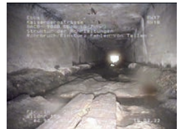
Die bestehenden Bachverrohrungen unterhalb der Straßenbereiche wurden vor vielen Jahren in Ortbeton betoniert und stehen am Ende der Lebensdauer.
