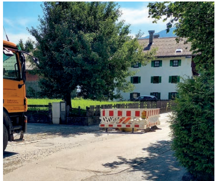
Da die Schäden in der Kaiserbergstraße nur kleinflächig sind, war die Absperrung des betreffenden Bereiches ausreichend.
