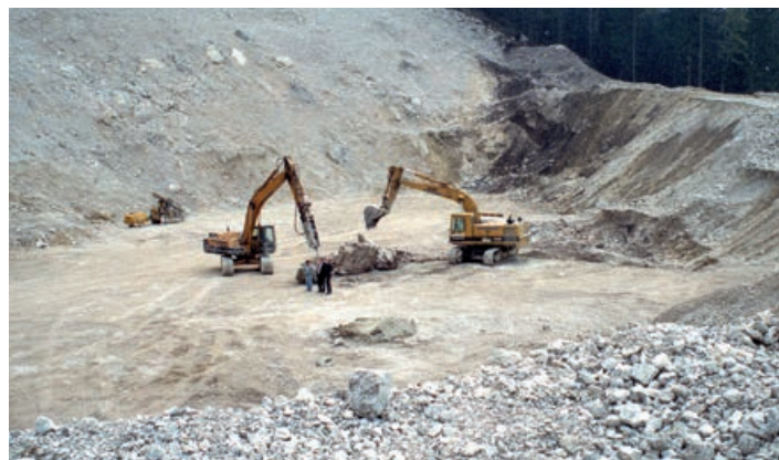
Der „Zankapfel Schanzer Lahn“. Die Erlöse aus dem Schotterverkauf ermöglichten später das Großprojekt Freizeitzentrum Hallo du. (Fotonachweis: OSR Georg Anker)
