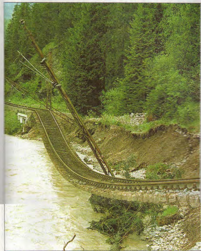
SCHÄDEN IN MILLIONENHÖHE, wie bei der Außerfernbahn, richtete das Jahrhunderthochwasser zu Pfingsten an. Foto: Papp
