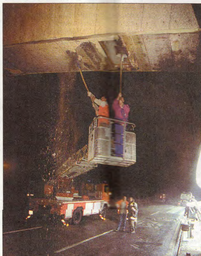
KNAPP AN KATASTROPHE VORBEI: In der Schönberg-Galerie gerät ein Lkw in Brand und beschädigt die Galerie.
