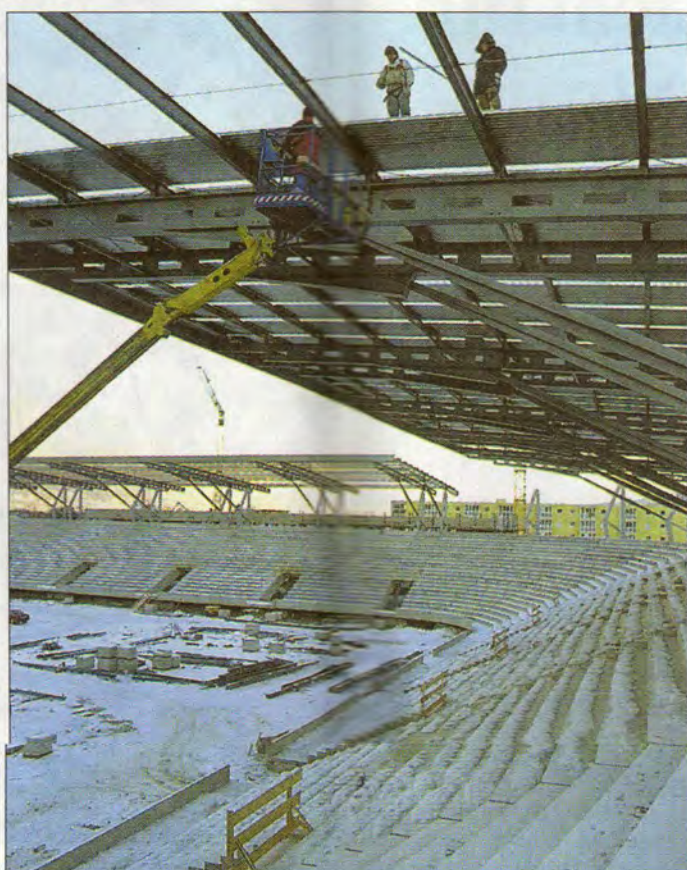
BAUSTELLE TIVOLI -NEU. Bereits im Herbst 2000 sollen die Fans dem FC-Tirol im neuen Stadion zujubeln.
