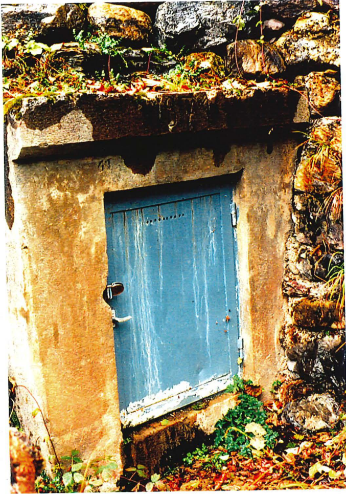
Neufassung der Wildbadquelle 1971: Obere Brunnenstube für das Wasser der Quelle 1
