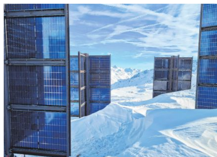
Dank der Kreuzstruktur der PV-Module bleiben die Photovoltaikflächen selbst am Tiefenbachgletscher schneefrei. Foto: Helioplant
