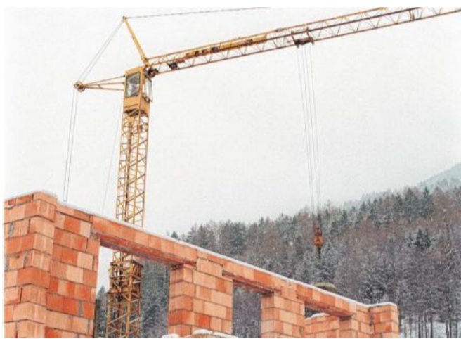
Rechtsfrage Kran: Für unbedingt erforderliche Baumaßnahmen muss der Nachbar das Überschwenken seines Grundstücks hinnehmen. Foto: Böhm
