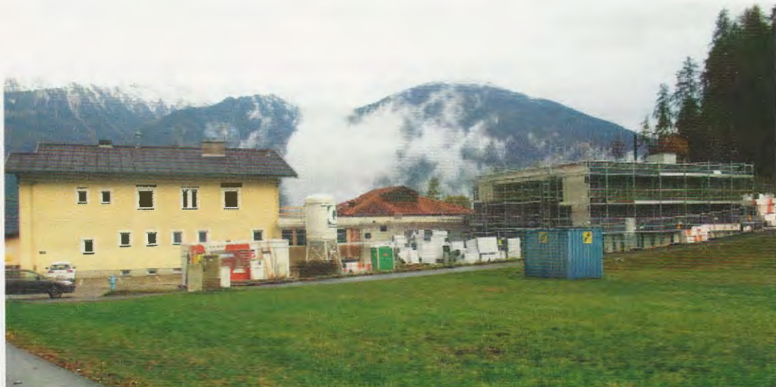
Das neue Mehrzweckgebäude in Karrösten soll im Frühjahr 2018 fertiggestellt sein. Herzstück ist ein neuer Saal für Veranstaltungen.
