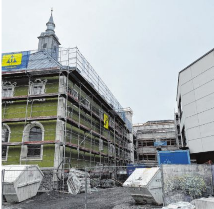
Vor allem der denkmalgeschützte Bereich des Klösterles (grün), aber auch der Tiefbau zur Erweiterung des Pflegezentrums schlug zu Buche. Foto: Parth
