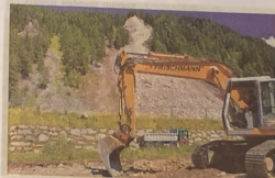
Letztlich brachen 15.000 m³ Gestein ab. Gestern wurde der Notweg entwickelt, bis zum Winter wird eine richtige Lösung fertig gestellt. Foto: Postinger
