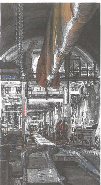
157 von 230 Kilometern Tunnel sind derzeit ausgebrochen, 2032 soll die Inbetriebnahme erfolgen. Foto: Böhm
