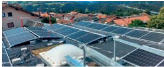
172 PV-Module in Ost-West-Ausrichtung erzeugen mit einer Generatorfläche von 322 m 2 rund 65 kWp elektrische Energie
