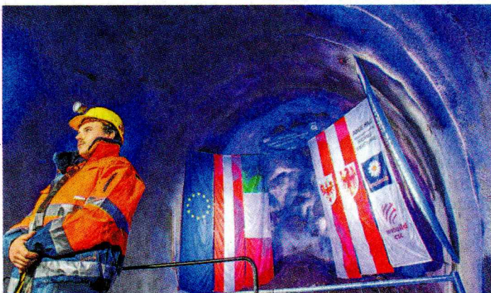
Ein Tunnel, der Tirol und Südtirol unter dem Brennermassiv verbindet. Der erste Tunneldurchschlag für den Hauptstollen in Tirol ist gestern erfolgt.
