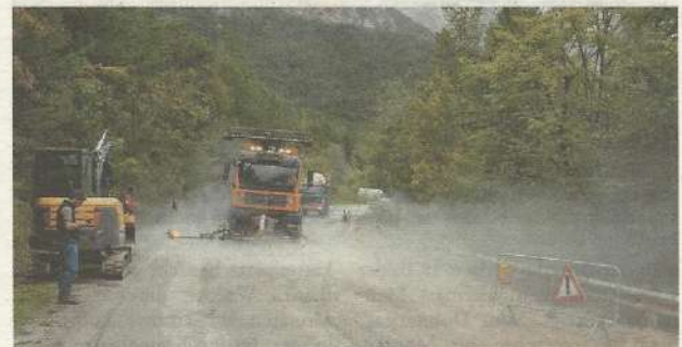
Auch Straßenreinigungsfahrzeuge standen im Einsatz, um die Spuren des schweren Gewitters zu beseitigen.
