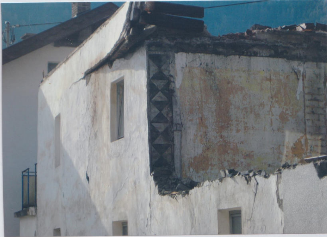
Beim Abriss kam eine bemerkenswerte Mauerverzierung zum Vorschein, ein Beweis, dass das Haus an dieser Stelle einen Zubau erhielt.
