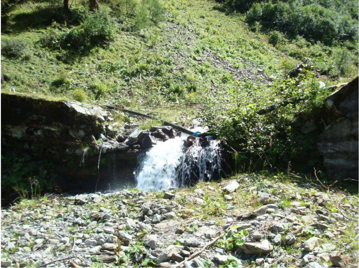
Abbildung 1: größtenteils zerstörte Konsolidierungssperren im Oberlauf
