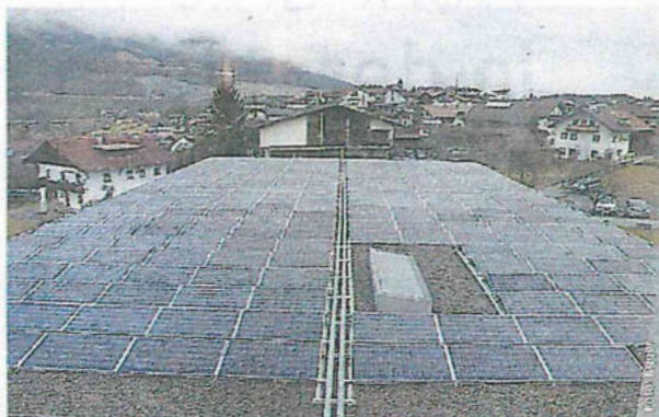
Die e5-Gemeinde Roppen, wo der Infoabend für die Gemeinderäte stattfinden wird, setzt unter anderem mit ihrer PV-Anlage ganz klare Schritte in Richtung Energiewende.
