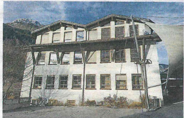
Für den Umbau der Volksschule sind für heuer Vorstudien geplant. Dringend erforderlich ist unter anderem die thermische Sanierung.
