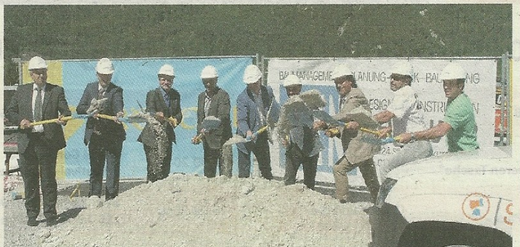
Mit vereinten Kräften wurde der Spatenstich in Angriff genommen. Supersnow setzt mit seinem neuen Werk auf kurze Wege zu den Skigebieten der Alpen.
