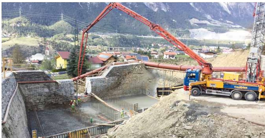
Bei der unteren Sperre werden an die 1000 qm Beton verbaut. Foto: Günter Neururer
