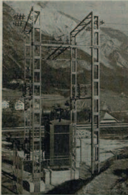
Abb. 5. Östliche Reaktordoppelspule im Unterwerk Köpven.
