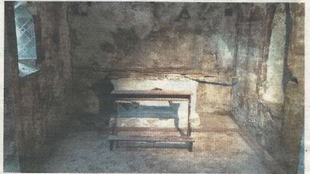
Vorher: Die Schäden, die über Jahrzehnte durch eindringende Feuchtigkeit entstanden, waren enorm.
