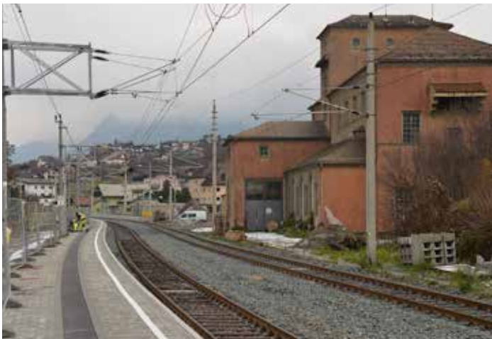
Noch wird beim Bahnhof mit Hochdruck gearbeitet. Gut Ding braucht eben Weile.
