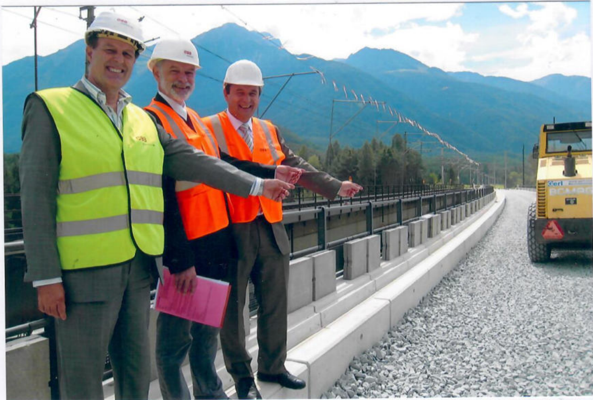
5. August 2011: Mit Stolz zeigen die Ingenieure die neue Brücke. Es müssen nur mehr die Schienen verlegt werden. Am 21. August rollt der erste Zug mit 80 km/h über das neue Schotterbett.
