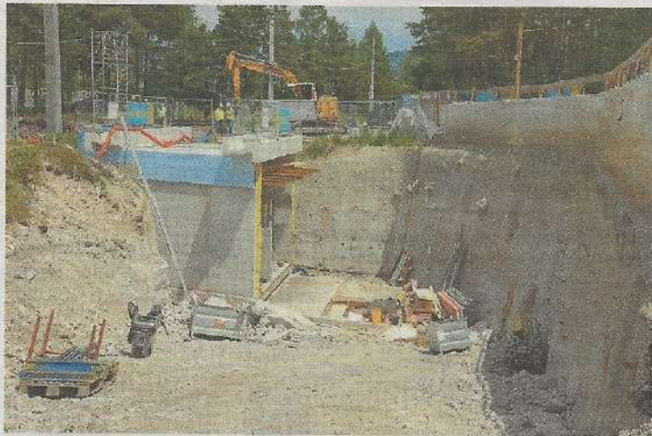
Nach Fertigstellung der Unterführung können auch Feuerwehr-Tankwagen und größere Rettungsautos die Riedegg-Siedlung anfahren.
