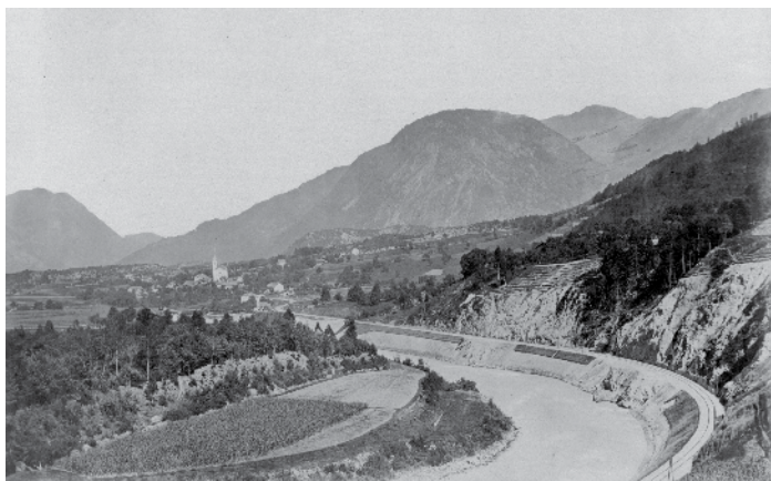
Bahnbau mit Blick nach Roppen. Mit dem Bau der Arlbergbahn wurde 1880 begonnen. Nachdem zwischen Innsbruck und Landeck der Verkehr am 1. Juli 1883 aufgenommen wurde, erfolgte die Freigabe der gesamten Strecke am 21. September 1884.
