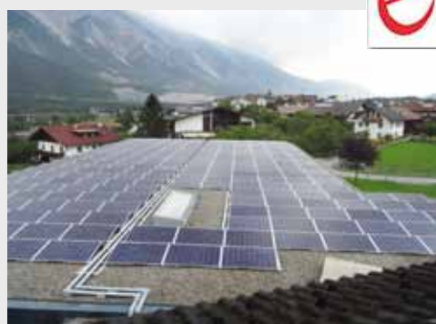
Die Photovoltaikanlage am Turnsaaldach produziert sauberen Strom aus Sonnenenergie.
