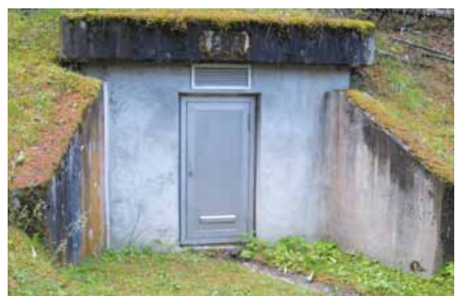
Der sanierungsbedürftige HB Hohenegg Foto: gem
