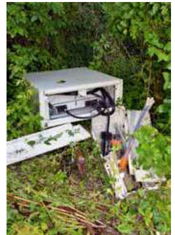
Der völlig demolierte LWL-Verteilerkasten. Fotos: Gebi Schnöll
