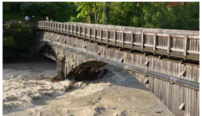
Holzbrücke musste nach Hochwasseralarm am Inn gesperrt werden. Foto: Schnöll
