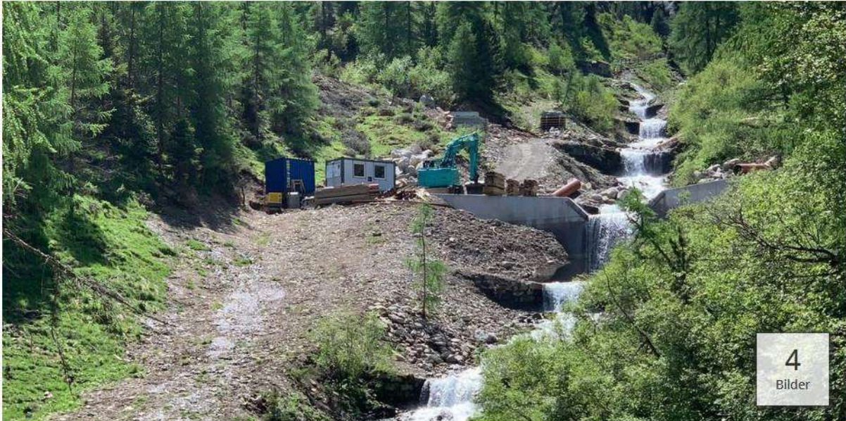
Die neu errichtete Verbauung im oberen Bereich des Leonhardsbach oberhalb der Maisalm wurde erst unlängst fertig gestellt. • Foto: Abler • hochgeladen von Clemens Perktold
