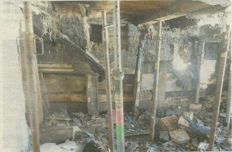
Das Wohnhaus wurde schwer in Mitleidenschaft gezogen. Der gesamte Kamin im alten Mauerwerk musste freigelegt werden.
