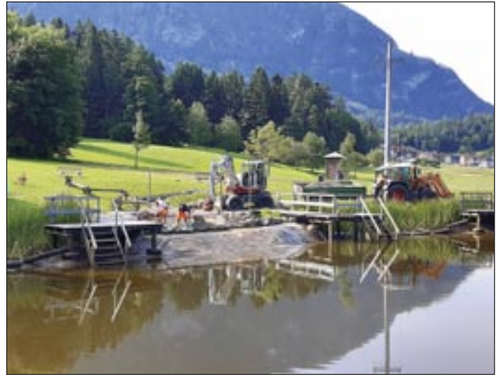
Der Schwoicher Bananensee wurde bei dem Unwetter verschlammmt und von der Gemeinde in Eigenregie wieder saniert.
