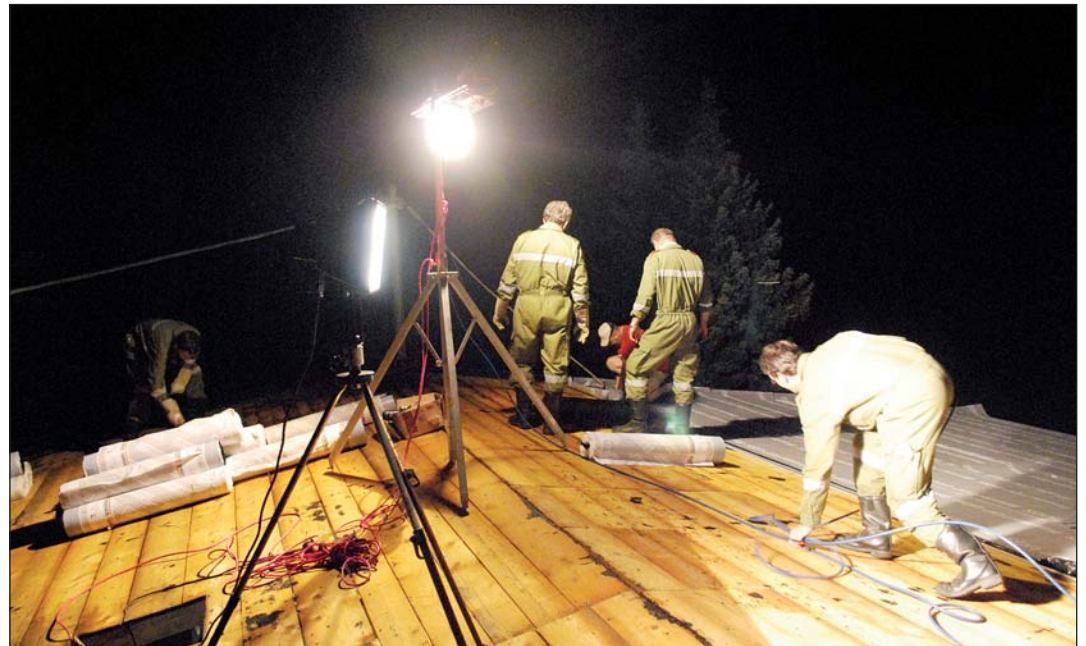
In Sonnendorf wurde ein Haus abgedeckt. Die Feuerwehr reparierte noch in der Nacht den ärgsten Schaden.
