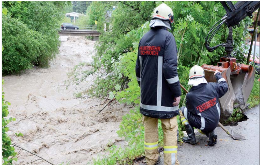
Die Feuerwehr musste den Uferbereich der Weißache bei Egerbach mit Steinen befestigen.
