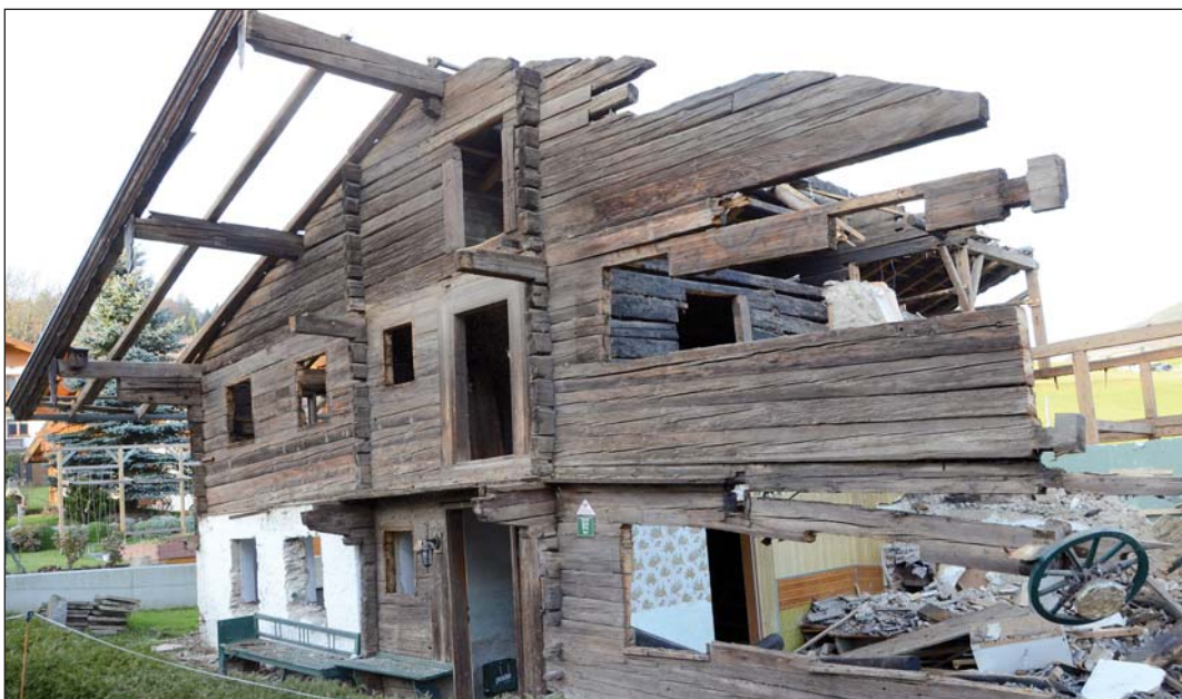
Ganze 467 Jahre hat der Hof „Learl“ überdauert, nun wurde das älteste Schwoicher Gebäude abgetragen.
