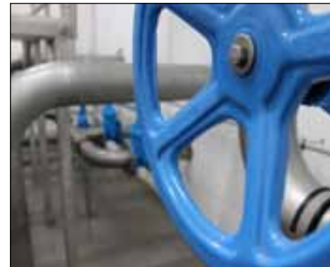
Trinkwasserkraftwerk der Gemeinde Sistrans © Gemeinde Sistrans
