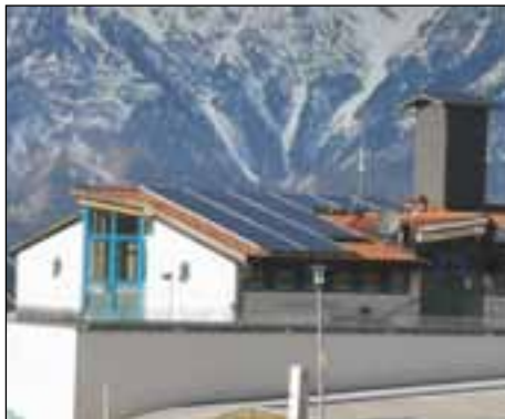
PV-Anlage auf dem Dach der Sporthalle © Gemeinde Sistrans
