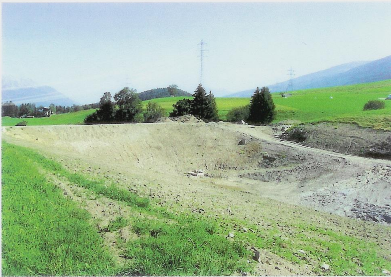
Das neue Retentionsbecken
