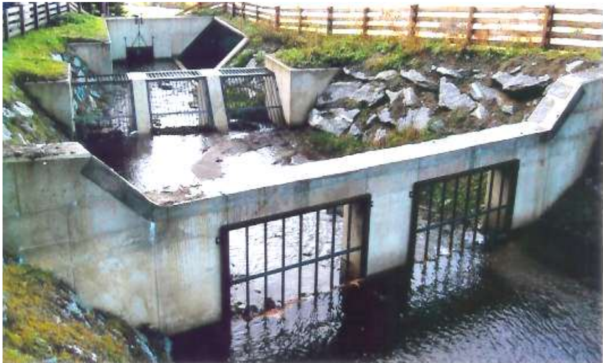
Auffangbecken beim Briggl's-Gatter
