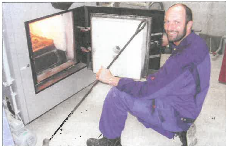
Werner Kofler bei der Kontrolle der Hackschnitzelheizung
