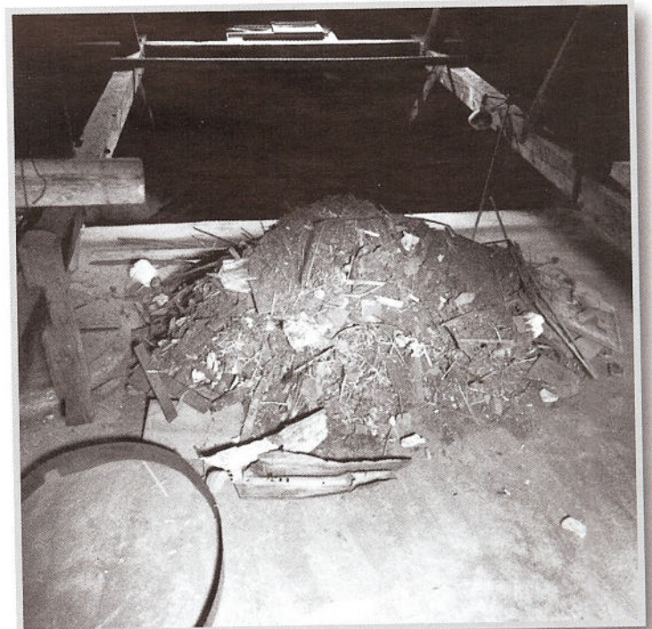
Bauschutt am Gurtbogen
