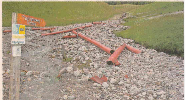
Oberhalb des Beckens wurden Wanderwege weggerissen und der Oberflächenwasserkanal beim Mairbach komplett beschädigt.
