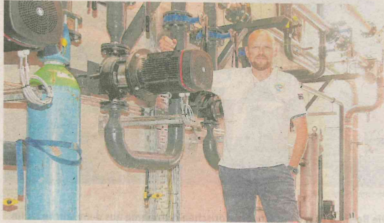
Bürgermeister Florian Gartlacher im Fernheizwerk, das mit neuer Technik ausgestattet wurde und im September in Betrieb gehen wird. Fotos: Walpoth
