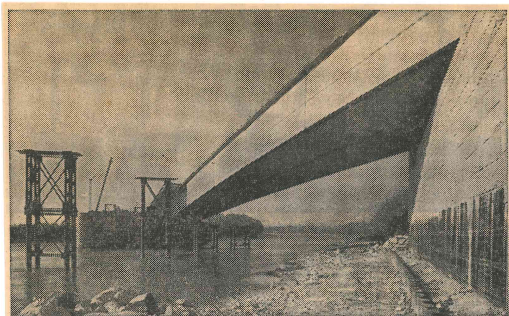
Eine Spannweite von 102 m hat die derzeit im Bau befindliche Innbrücke der Autobahn bei Terfens.
