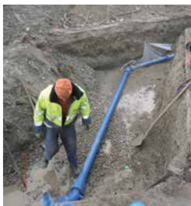
Damit die Haushalte mit Wasser versorgt werden können, ist ein intaktes Rohrsystem sehr wichtig.
