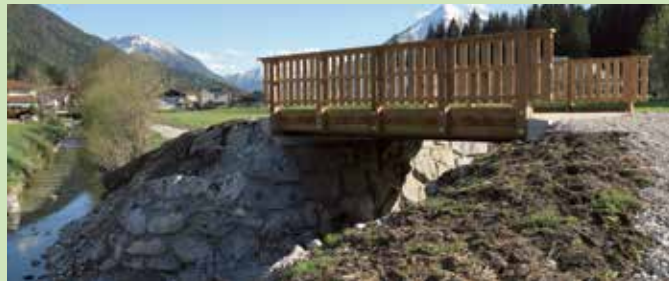
Gleich nach der Schneeschmelze wurde mit dem dringend erforderlichen Neubau der Loipen- und Fußgängerbrücke über den Schröfelsbach begonnen. Die Brücke wurde nach den Kriterien für die Regulierung der Seeache geplant und auch ausgeführt, so dass diese dann auch in dieses Projekt integriert werden kann (Uferbegleitweg). Die Sanierungsmaßnahmen waren aufgrund des schlechten Zustandes beider Brücken dringend erforderlich.
