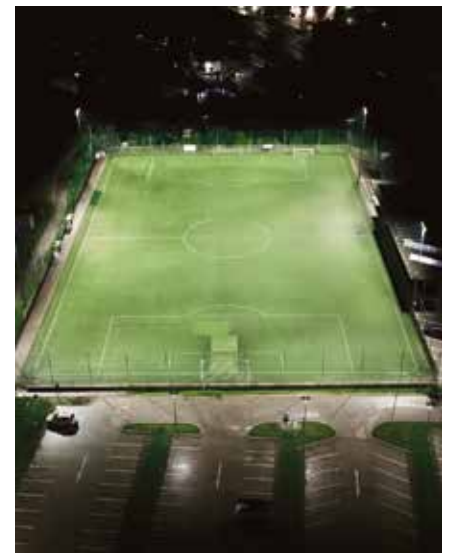
Neue LED-Flutlichtanlage beim Fußballplatz.
