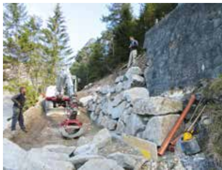
Sanierung bzw. Errichtung einer neuen Steinschichtung an der Seeuferstraße, da diese hinterspült wurde und teilweise Richtung See abgebrochen ist.
