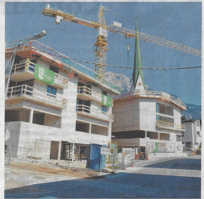
Das neue Dorfzentrum Wiesing kommt wuchtig daher. Die Straße wird noch um ca. 60 bis 80 Zentimeter abgesenkt.
