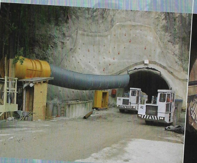
Abb. 7: Bewetterung für die Vortriebsarbeiten
