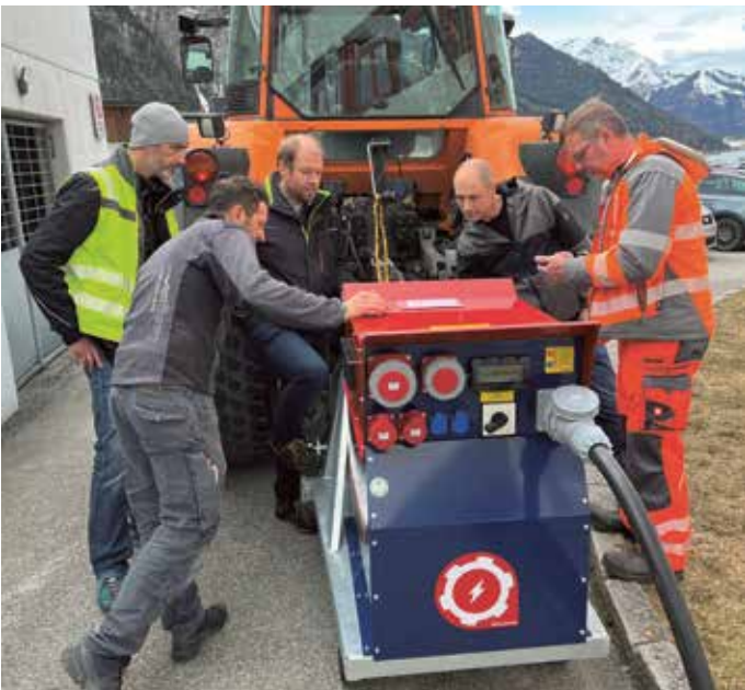
Ein neues Notstromaggregat sichert die Stromversorgung der Mittelschule Achensee bei längeren Stromausfällen.
