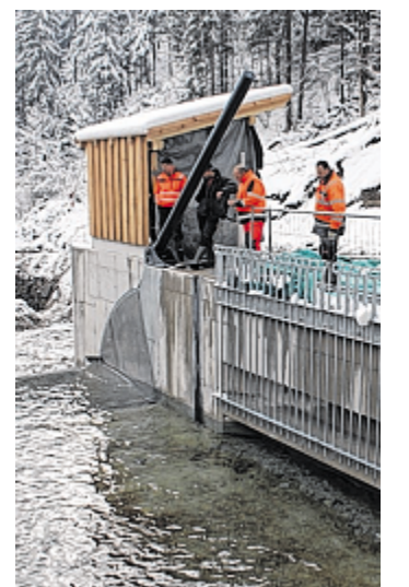
Die Wasserfassung des E-Werkes Prantl am Kasbach. Foto: Zwicknagl
