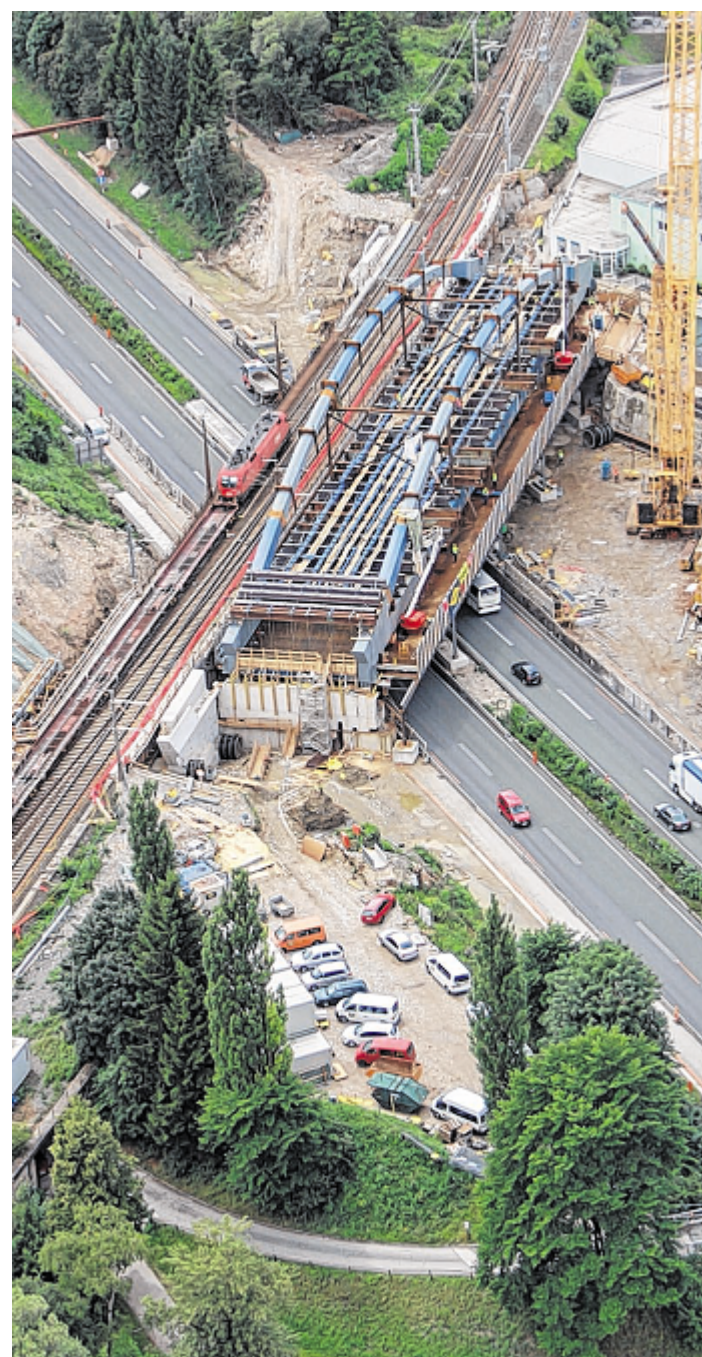
Die neue Eisenbahnbrücke bei Kramsach (r.) ist fertig und wird ab 14. August auf die Fundamente der alten geschoben.
