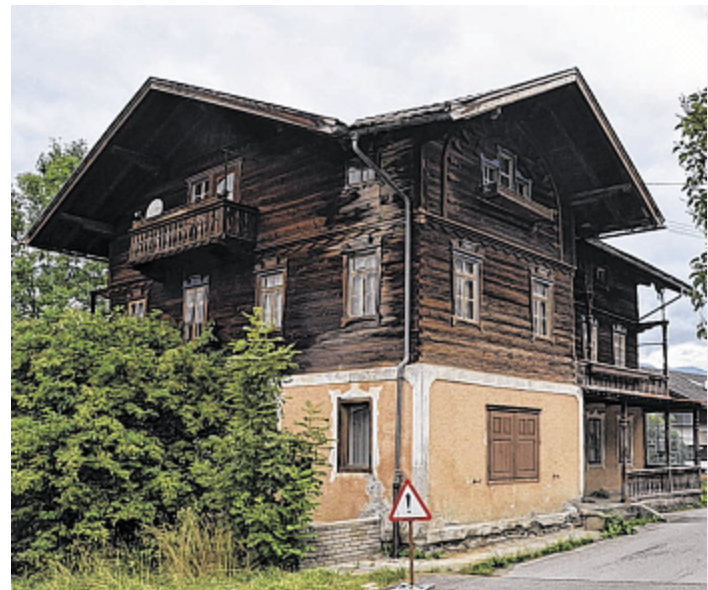
Eine Tafel soll vor der Gefahr durch herabfallende Dachplatten warnen. Nach dem Unfall wurde das baufällige Haus versperrt. Foto: Dähling
